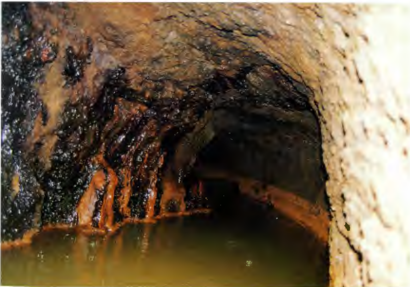
Foto 3: Vista de la galeria A, de la galeria D. A la banda esquerra d'aquesta galeria és visible un pla de discontinuïtat en els materials, gràficament interpretat a la figura C. Aquest pla constitueix un conducte permeable on circulen aigües amb una alta concentració de Fe^{+2} que precipita en forma d'òxids (colors ocres).
